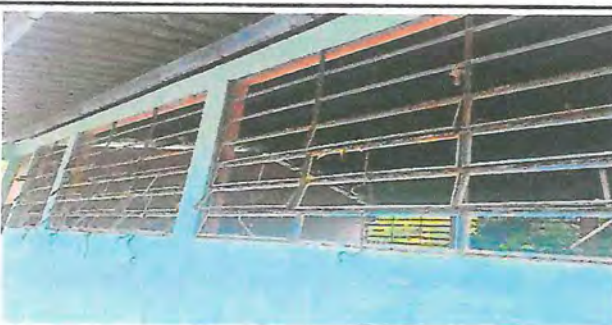
Foto 5: Ventanas sin vidrios.
