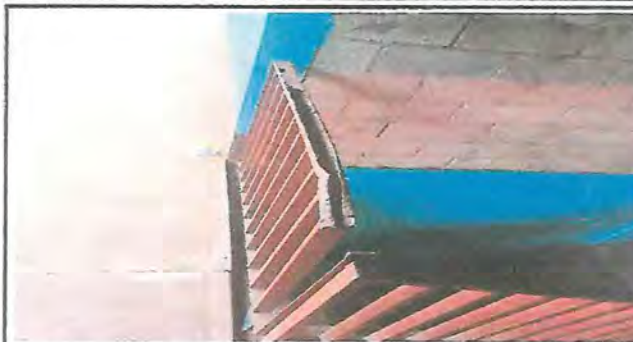
Foto 2: Barandales de segundo nivel establecimiento destruidos.
