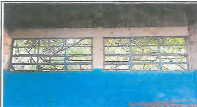
Foto 1: Pintura del establecimiento en mal estado.
