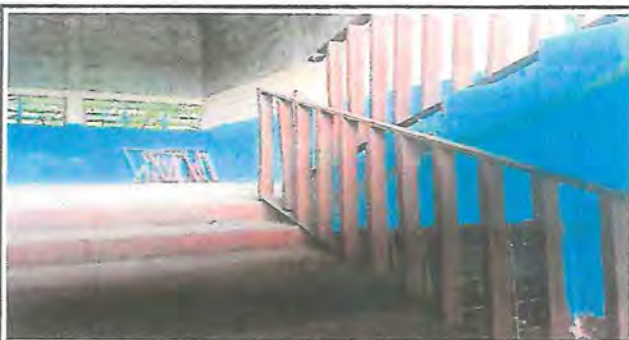
Foto 3: Barandales de gradas en mal estado.
